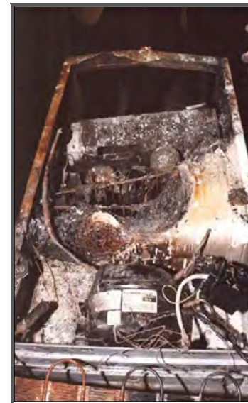
Surchauffe de la cloche d'un réfrigérateur
